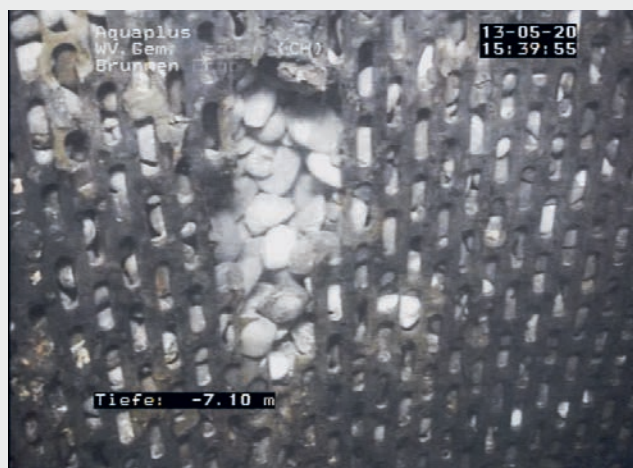
Stark korrodierter und beschädigter Brunnenausbau aus Stahl.
