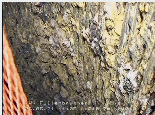
Inkrustationen im Filterbereich.
